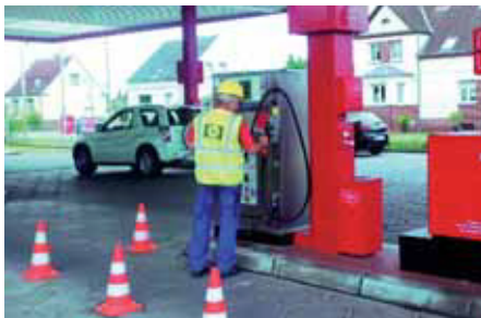
Als Fachfirma für die technische Betreuung und Spezialist für Reparaturen an Autogasfüllanlagen hat sich Schröder Gas in Nord-, Mittel- und Ostdeutschland einen Namen gemacht.
